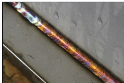
ステン溶接焼け 酸洗前
